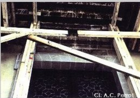
Dégradation du tuffeau liée aux sulfates et nitrates
