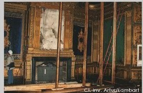
Moisissures derrière les panneaux de bois
