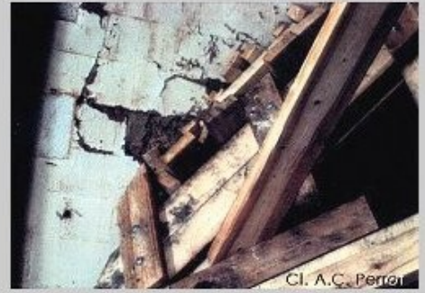
Infiltrations d'eau dans la maçonnerie
