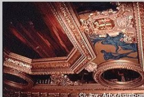
Infiltrations dans les caissons
