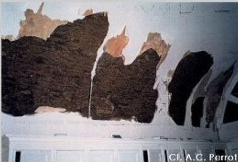
Chute d'enduit saturé en eau
