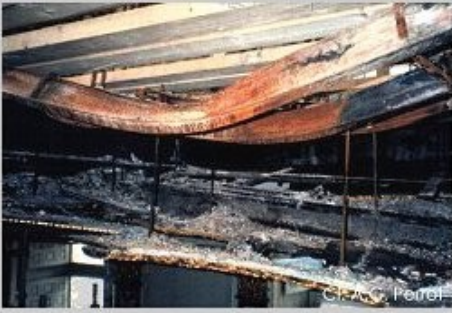
Déformation de la structure métallique
