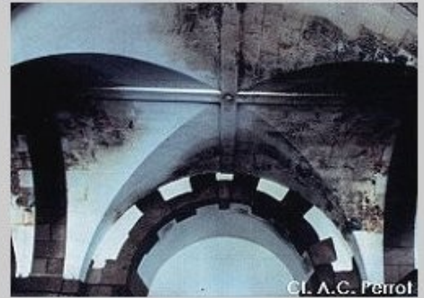
Moisissures à un stade développé
